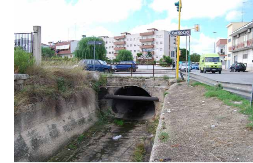
Foto n.8 - Attr. n.4 - Condotta ARMCO
